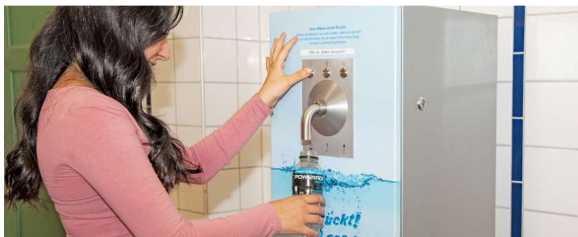
Abbildung 29: Wasserspender der Berliner Wasserbetriebe
